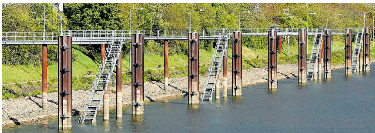
Das Museumsschiff (Bild oben) soll auf der Seite zur Fahrinne des Neckars hin mit Stahlpfeilern, sogenannten Dalben, als Rammschutz abgesichert werden. Das Bild unten zeigt ähnliche Stahlpfeiler im Neckarkanal westlich der Schleuse. BILDER: TRÖSTER
